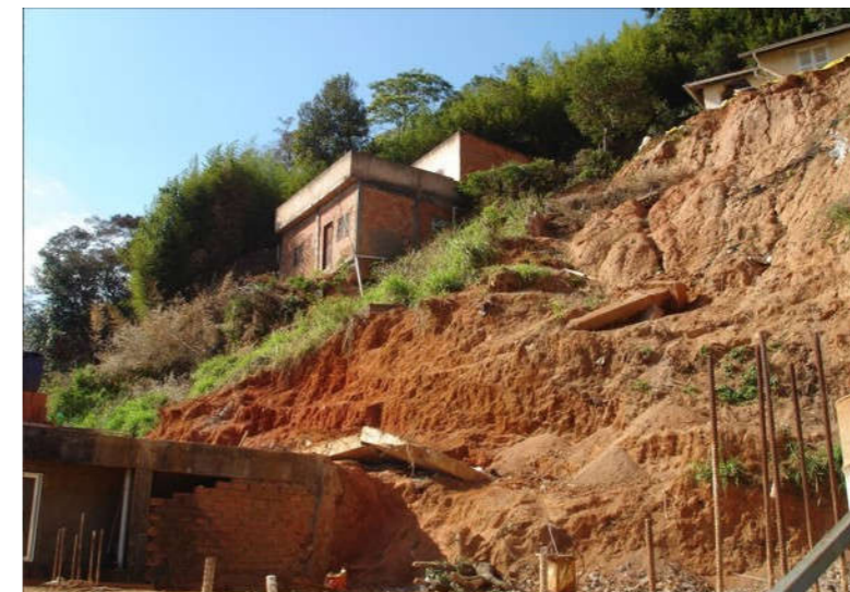
Foto 3.11 –Deficiência de drenagem e corte inadequado.
