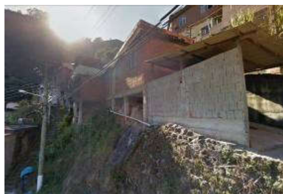
Foto 016 – Moradias sem infraestrutura.
