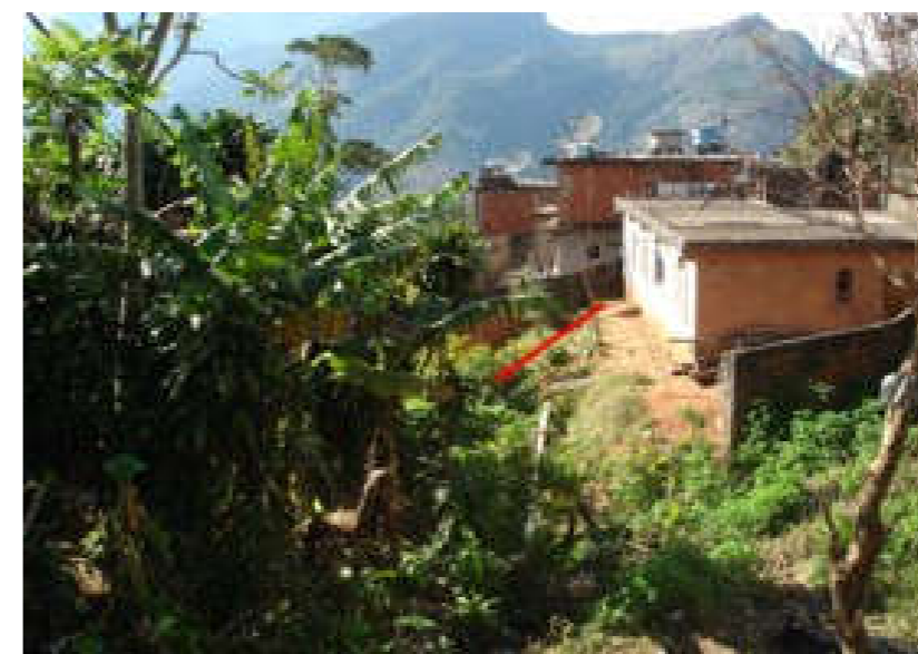
Foto 3.6 – Deficiência no sistema de despejo e destino final do esgoto.
