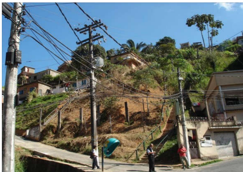
Foto 3.12 – Encosta sem proteção superficial – alteração antrópica.
