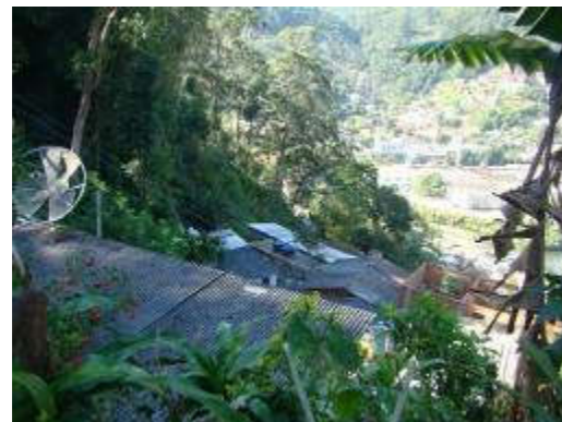
Foto 031 – Ocupação dentro da drenagem.
